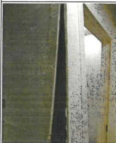
Foto 10: 153: beschadiging (excl. vochtschade) of verwerking / noodzakelijke afwerking ontbreekt
