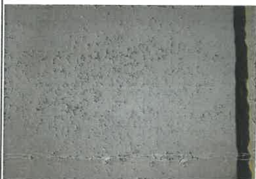
Foto 4: 21: vervorming en/of scheurvorming van gevelvlak of gevelelementen
