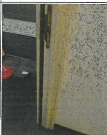
Foto 11: 153: beschadiging (excl. vochtschade) of verwerking / noodzakelijke afwerking ontbreekt
