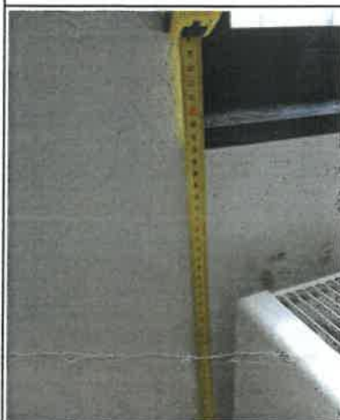
Foto 14: 233: ontbrekende of onvoldoende hoge/stevige borstwering bij lage ramen (vanaf eerste verdieping)
