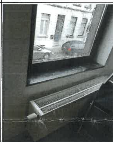
Foto 15: 233: ontbrekende of onvoldoende hoge/stevige borstwering bij lage ramen (vanaf eerste verdieping)
